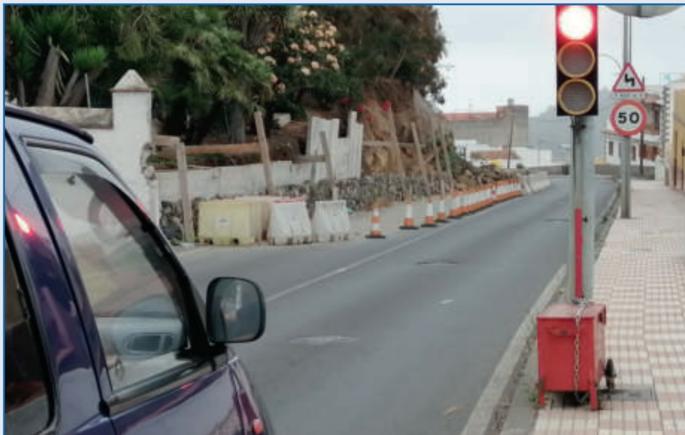
Täglich gibt es zu Stoßzeiten Staus wegen der eingestürzten Monasteriomauer (Foto/Cedida)
